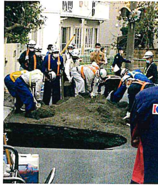
調布の陥没事故現場
